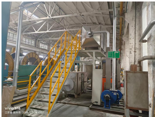
DA007排气筒和标识牌
