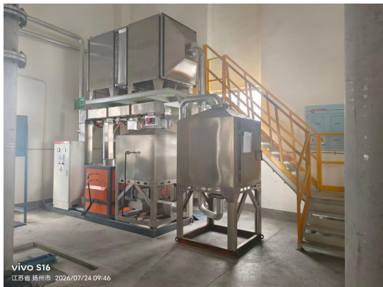
DA001对应废气处理设施
