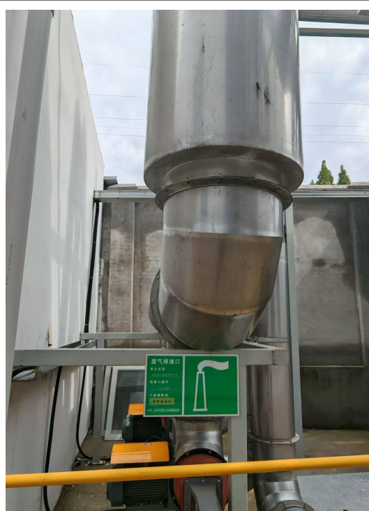
DA009 排气筒和标识牌
