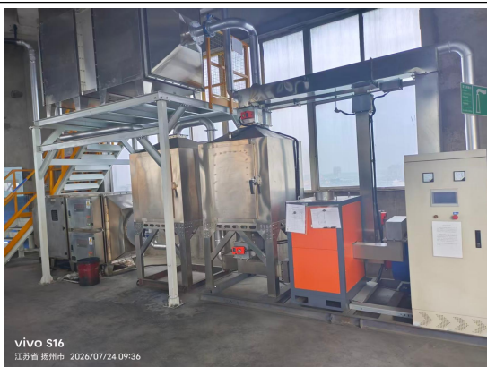
DA008对应废气处理设施
