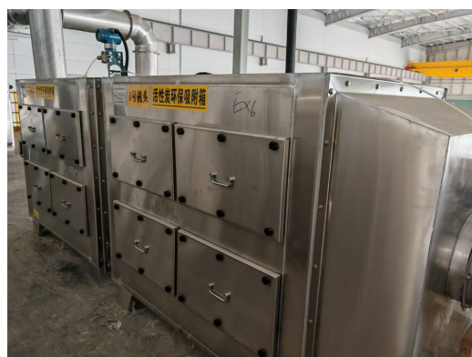
DA009 对应废气处理设施
