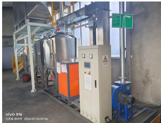
DA008 排气筒和标识牌
