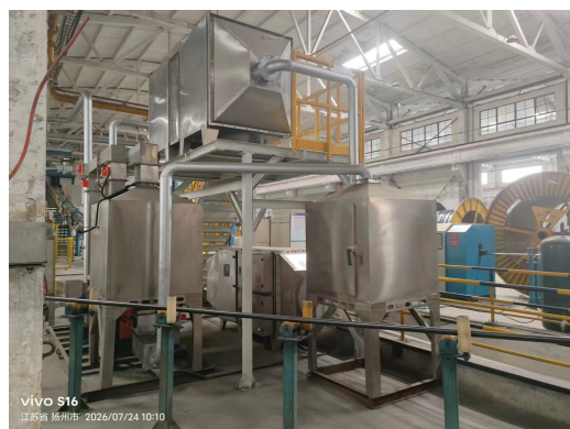
DA007 对应废气处理设施
